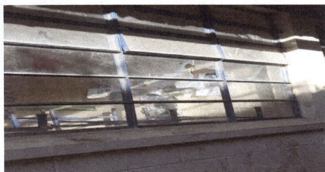
Foto 3: Actualmente los vidrios de las ventanas la mayoría están quebradas es necesario cambiar los vidrios
