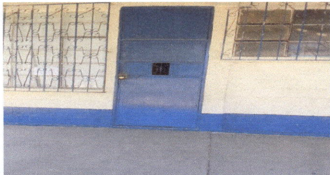
Foto 1: Las puertas de las aulas y de la dirección ya no cuentan con chapas
